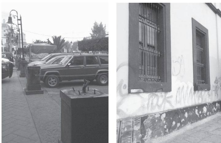
Figura 3. Condiciones de deterioro de luminarias y grafiti en fachadas del Centro Histórico
